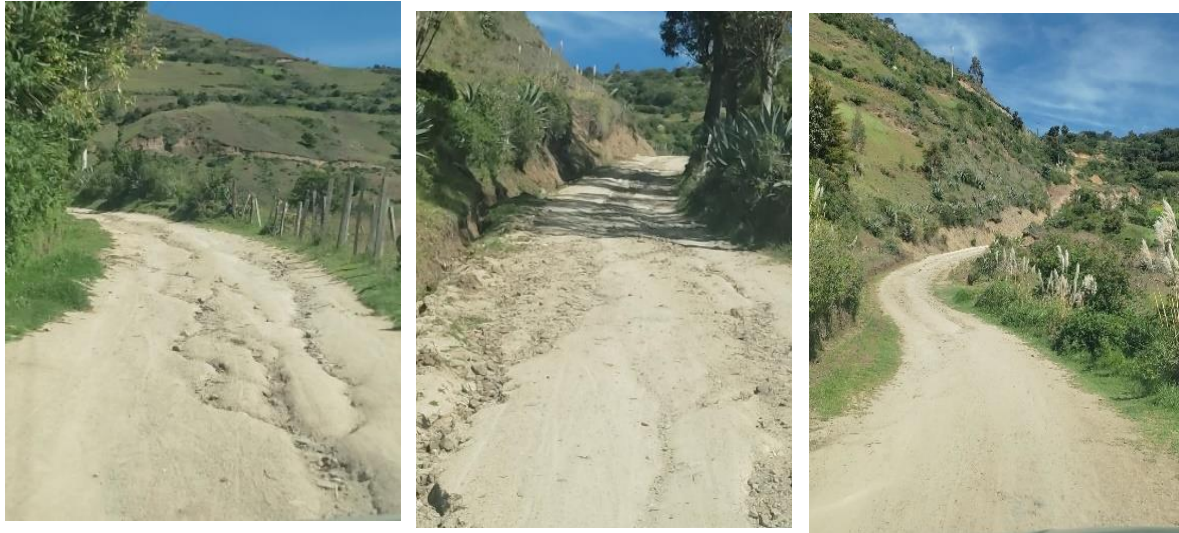
Registro fotográfico del estado vial comunidad Zhinincalle. Elaborado: Equipo consultor, 2024
