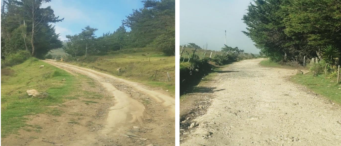
Figura 12. Estado vial en la comunidad Cuzhcapa
